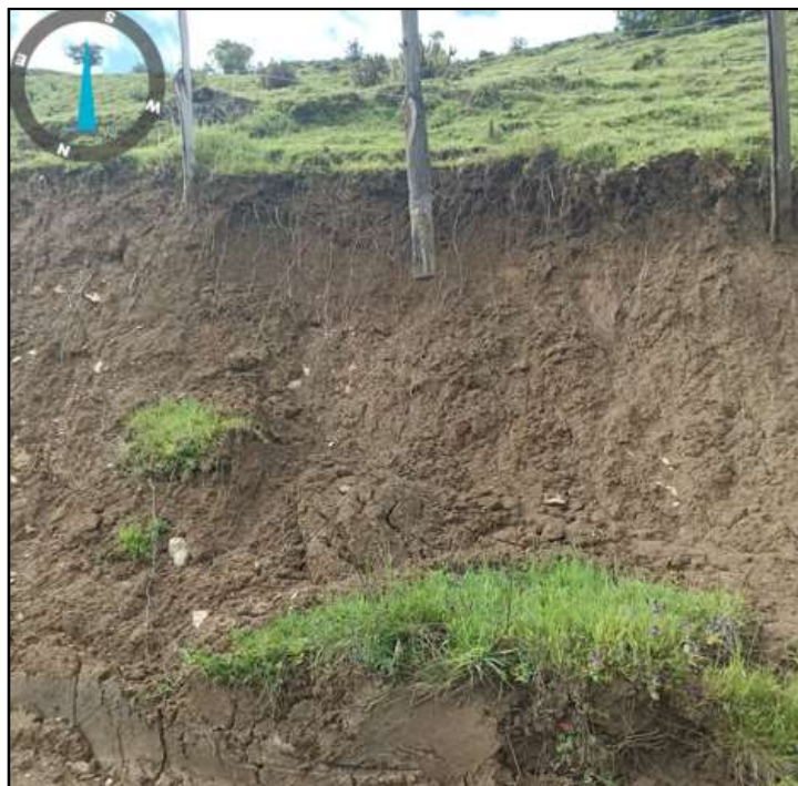
Deslizamientos del talud de la carretera a Shamon. La línea de conducción está instalada cerca de la carretera.
