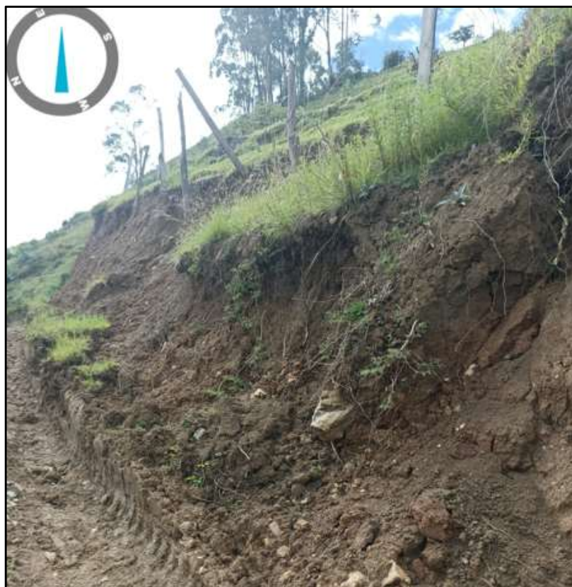
Carretera a captación Shamón en invierno se presenta deslizamientos a lo largo de la línea de conducción.
