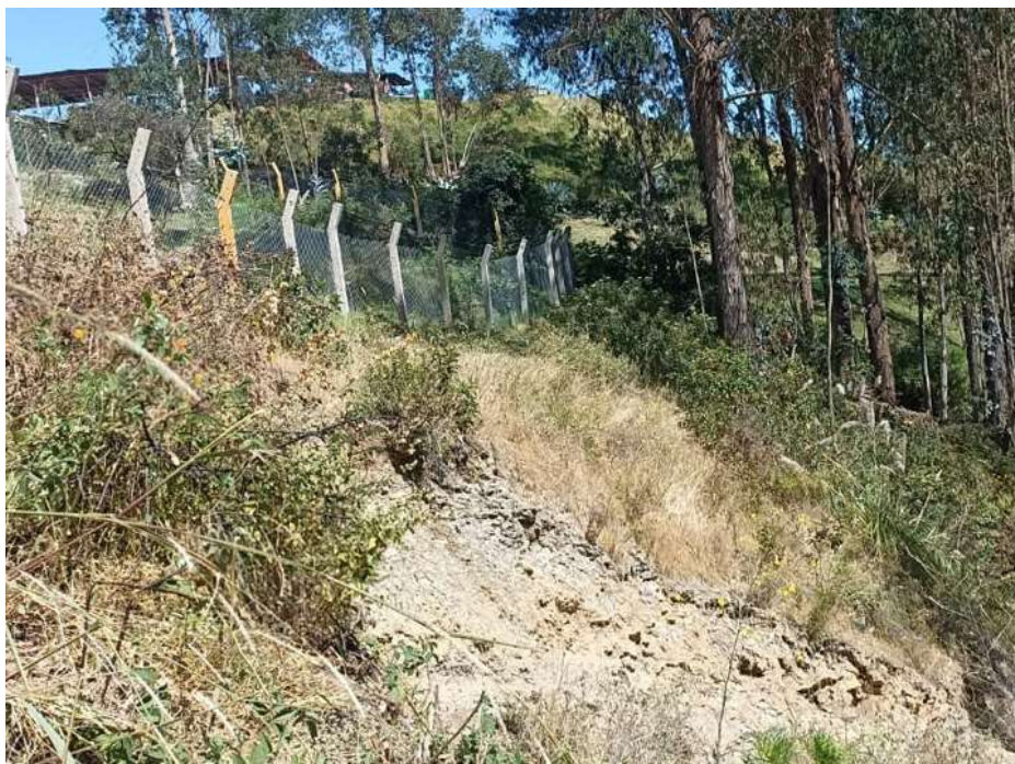
Deslizamientos de terrenos, por esta zona está instalada la red de alcantarillado.
