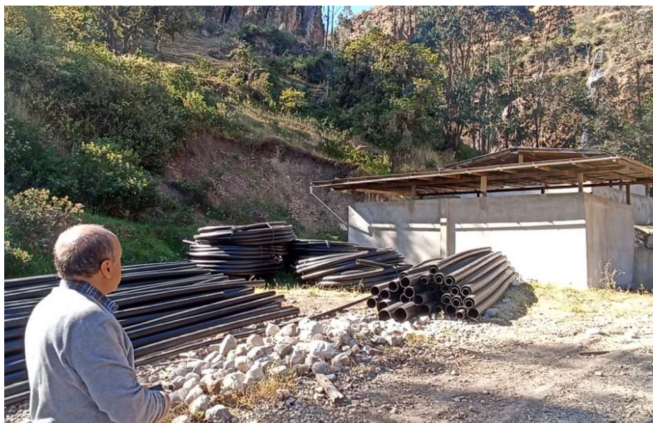
Estructuras sanitarias de la PTAR Contumazá, adyacente a una zona de deslizamiento.
