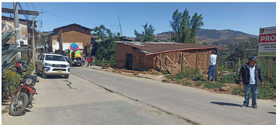
Zona de movimiento de tierras, el pavimento se ha asentado aplastando la tubería de la red de desagüe.
