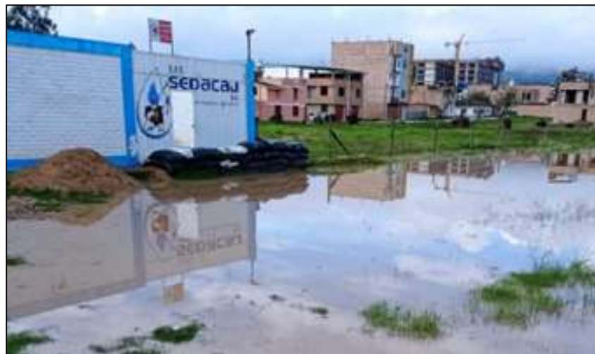
. Cámara de bombeo de aguas residuales Ajoscancha, inundado en la temporada de lluvias.
