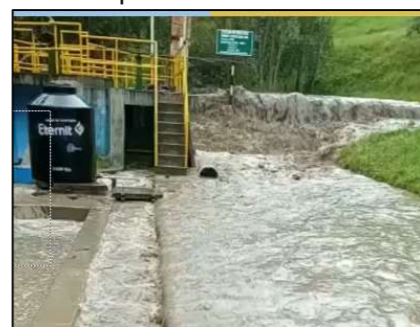
Inundación en Captación rio Grande
