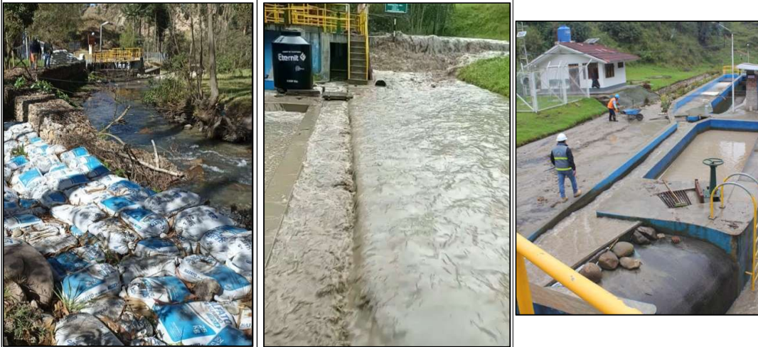
Captación río Grande, con muros de gaviones incompletos. Inundación y limpieza de la captación en abril 2022.
